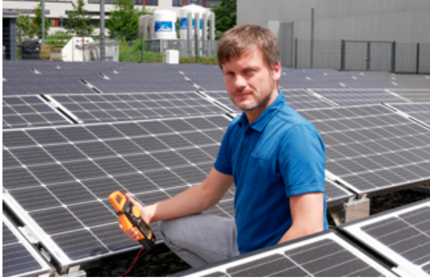
196 Solarmodule der modernsten Generation sind in der neuen Freifeldanlage am Fraunhofer CSP installiert und werden für Messungen eingesetzt. Gemeinsam mit weiteren Modulen auf dem Gebäudedach verfügen sie über 100 kWp nominale Leistung. Der von der Anlage erzeugte Strom wird in Teilen auch vom Fraunhofer CSP selbst genutzt. Jens Fröbel koordiniert die Aktivitäten.
